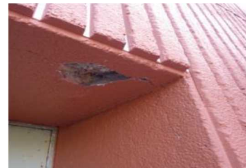
海洋文化館のコンクリート部の劣化
