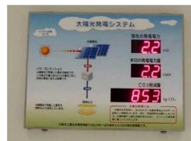
太陽光発電システム表示パネル
